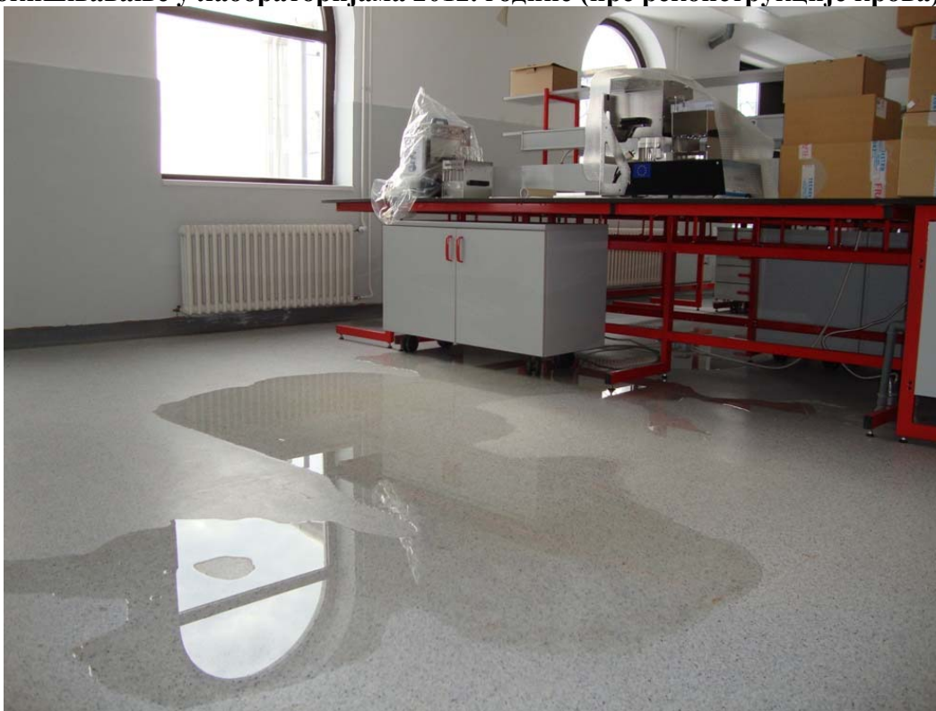
Прокишњавање у лабораторијама 2012. године (пре реконструкције крова)
